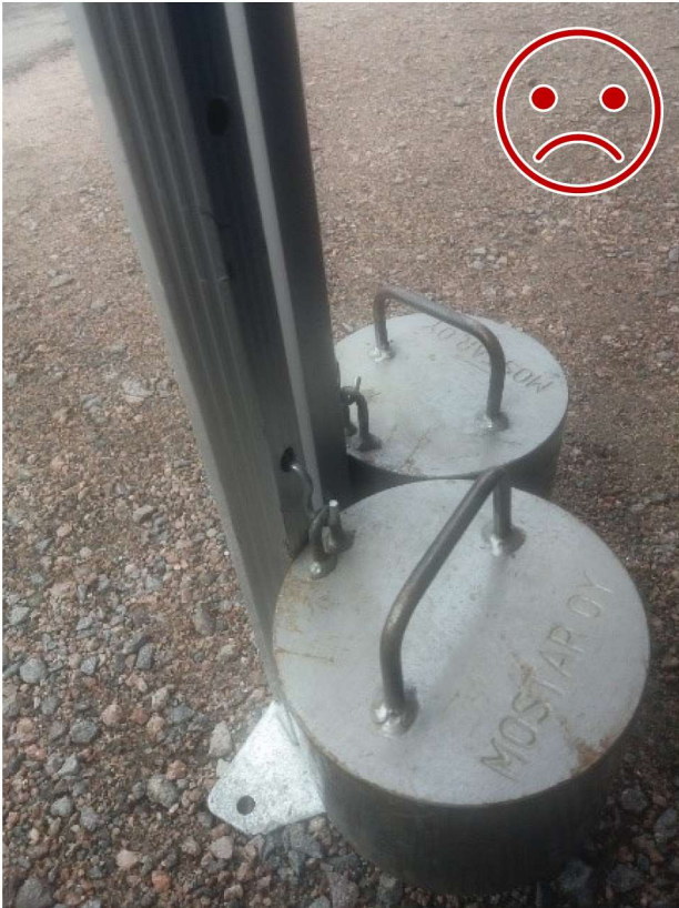
Kuva 9 Ei NÄIN. Teräskoukku ei lukkiudu rakenteeseen. Lisäksi teräs leikkaa alumiinia nosteen ravistellessa telttaa.
